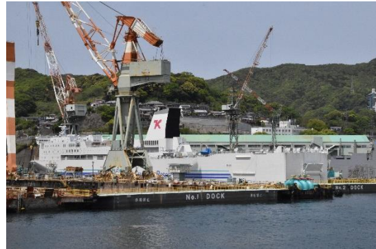
ドックの中では、東京九州フェリー用の新造船の2番船「それいゆ」の艀装工事がドック内で進んでいました。7月から横須賀～新門司航路に就航します。
